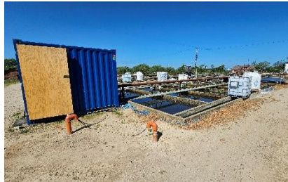
Stærkstrøms- og datakabler er ført gennem nedgravet rør for at sikre at daglig trafik på dambruget ikke beskadiger disse.
