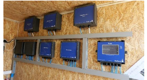
OxyGuard Pacific databehandlings-anlæg i container 1 og 2
